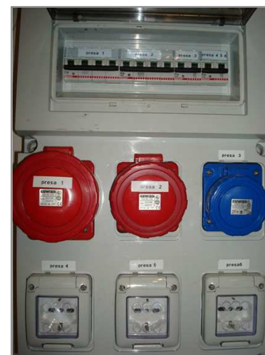
Коробка главного выключателя
