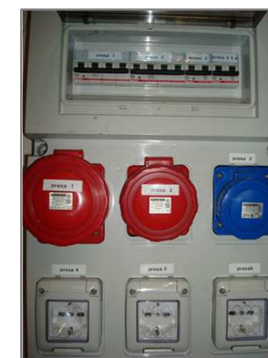
Коробка главного выключателя
